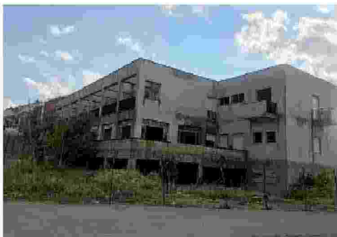
L'IMMOBILE DEGRADATO AD AIDONE
