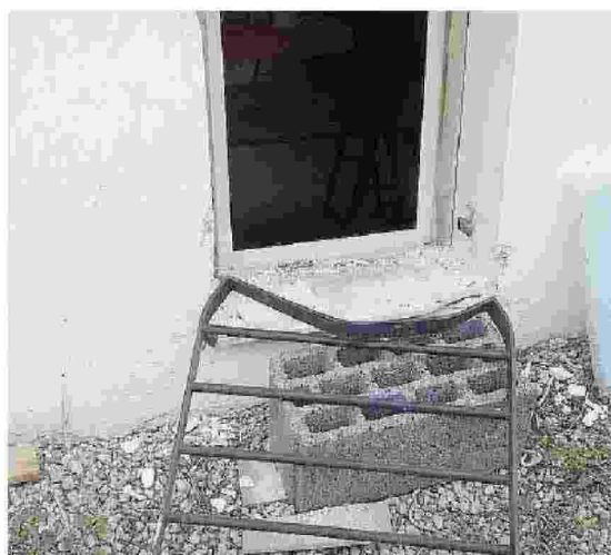
L'intrusione. La grata divelta dai ladri per entrare nei locali
